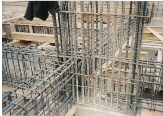
Gambar 3.20 Pemasangan besi beton pada pertemuan empat balok dan sebuah kolom, dimana ada kemungkinan terjadi jarak bersih antara besi lebih kecil dari persyaratan minimum jaraknya, sehingga agregat kasar banyak yang menyangkut, mengakibatkan keropos dibawahnya.
