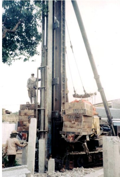
Gambar 2.9. Penekanan tiang pancang (gambar kanan). Tiang pancang berukuran kecil bentuk penampang segi tiga
