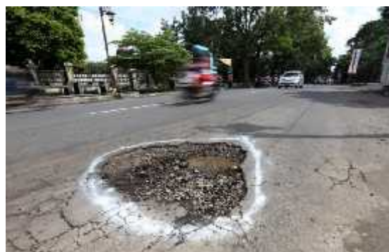
Gambar 6.2 Tanda Jalan berlubang
