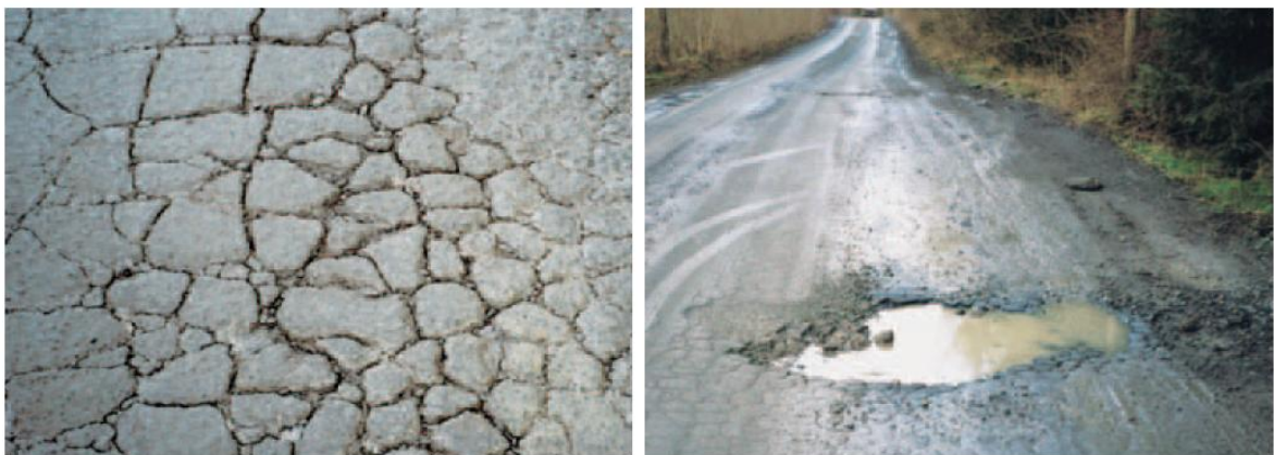
Gambar 2.1. Kerusakan Permukaan Jalan; (a) Retak kulit buaya, (b) Genangan air menetap yang merusak permukaan jalan (Wirtgen).
