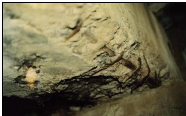
Gambar 4-11 Korosi pada tulangan gelagar
