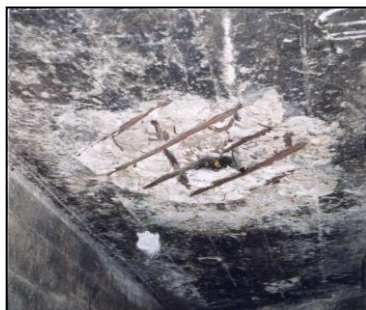
Gambar 4-12 Korosi pada tulangan lantai
