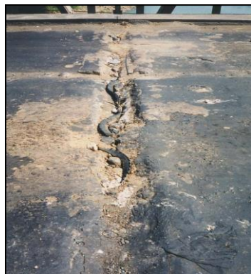
Gambar 4-4 Kerusakan pada expansion joint
