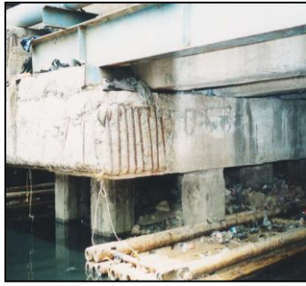
Gambar 4-9 Korosi tulangan kepala pilar
