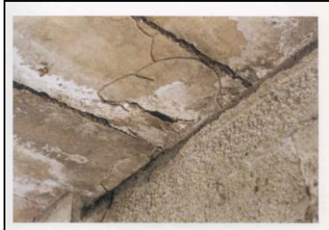
Gambar 4-3 Kebocoran pada bagian atas lantai
