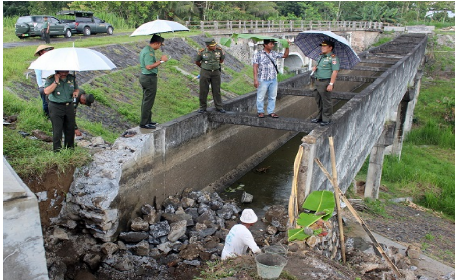
Gambar 1 : Kerusakan Saluran (selopos.com)
