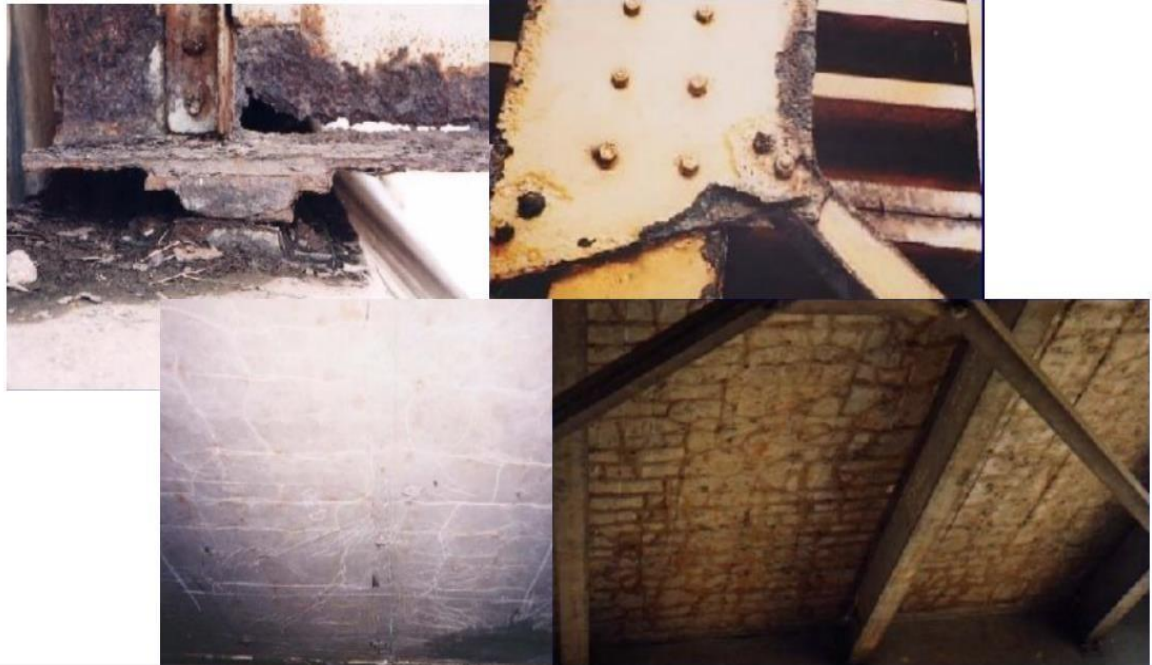
Gambar 9 : Tidak ada pemeliharaan sehingga rangka jembatan kropos
