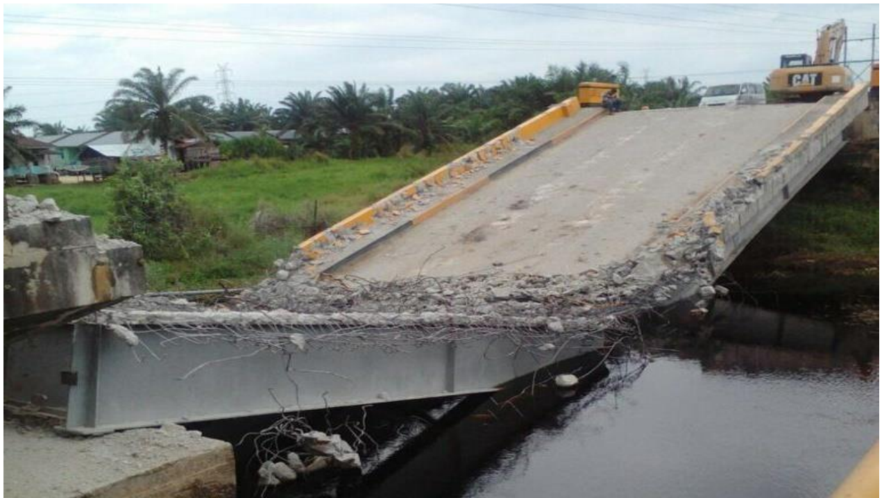
Gambar 14 : Jembatan Runtuh saat Pemeliharaan.
