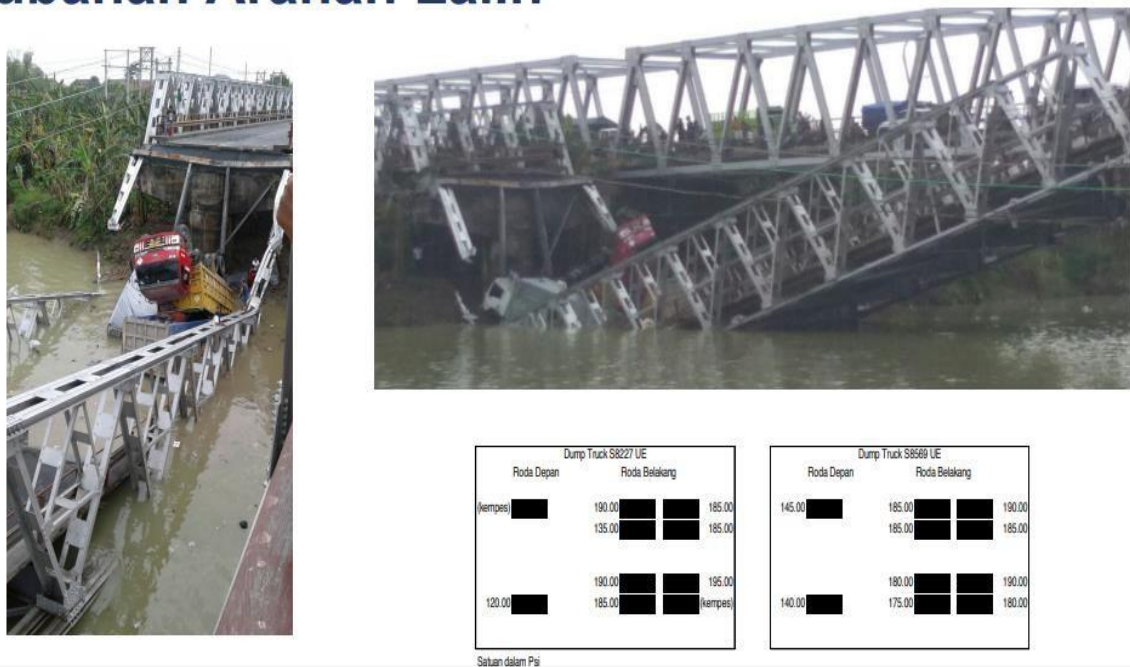
Gambar 6 : Runtuh akibat perubahan arah Lalu Lintas
