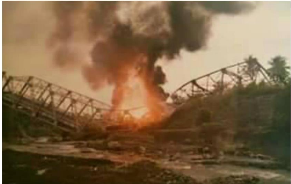
Gambar 11 : Akibat kebakaran kendaraan diatas jembatan sehingga jembatan runtuh.
