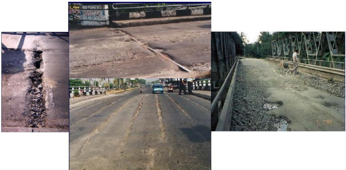
Gambar 8 : Tidak ada pemeliharaan sehingga jalan rusak di atas jembatan.
