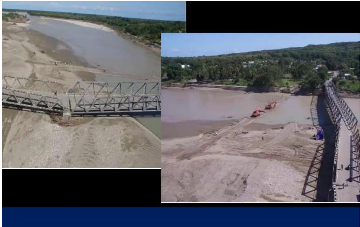
Gambar 13 : Jembatan Runtuh akibat Banjir dan Scoring
