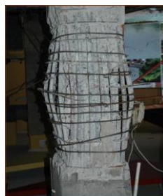
Gambar 1 : Sistim tulangan tidak cukup di Jogjakarta
