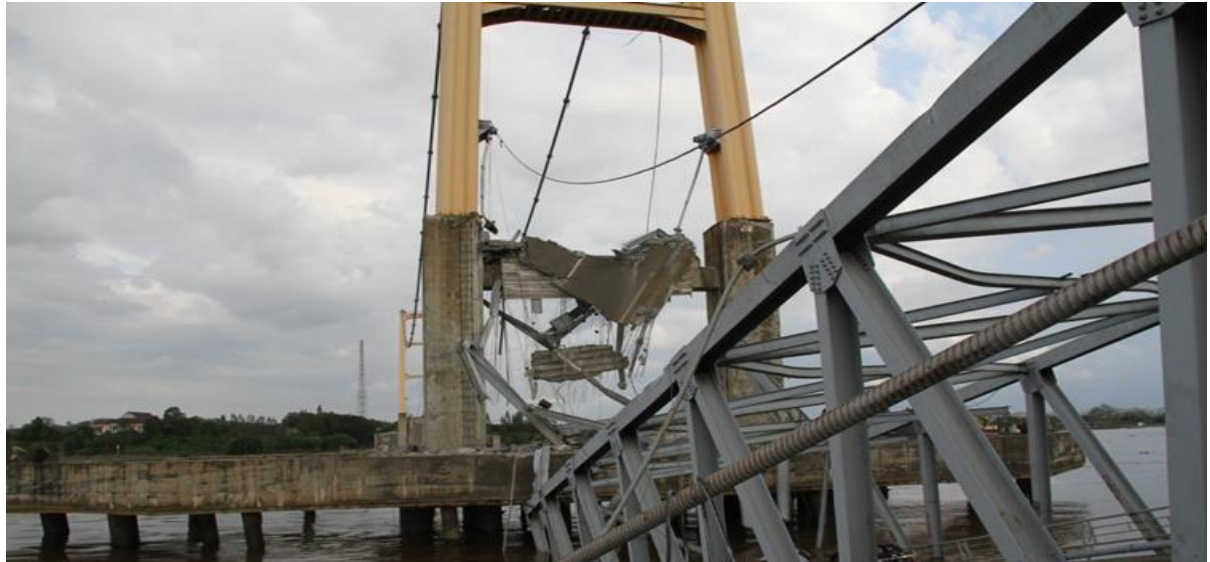
Gambar 4 : Jembatan Kutai Kertanegara ambruk saat Pemeliharaan.
