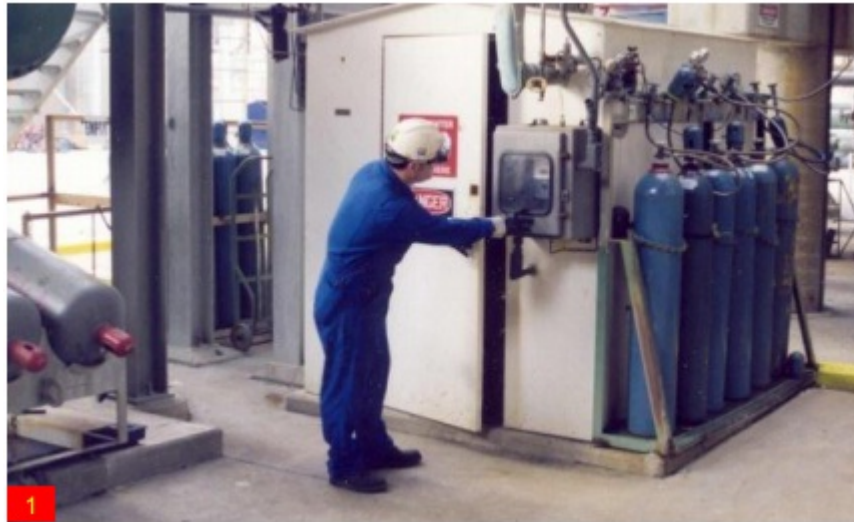
Gambar 1. Bangunan untuk analisis yang bertekanan (udara dengan back up nitrogen)
