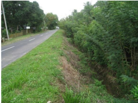
Gambar 7.23 Hazard sisi jalan.
