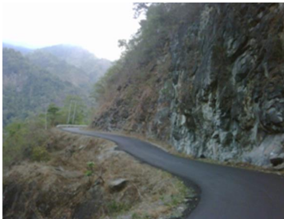
Gambar 7.24 Hazard sisi jalan.
