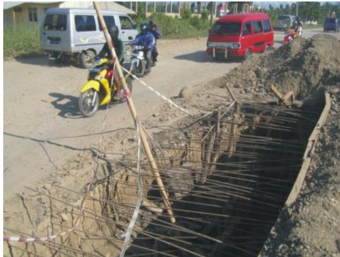
Gambar 4.3 Pekerjaan galian ini tanpa delinesasi dan pagar pelindung. Ini menyebabkan risiko tinggi bagi pengguna jalan, khususnya pada malam hari.
