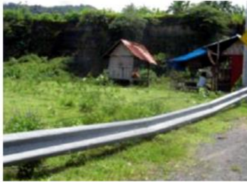
Tiang-tiang yang hilang memengaruhi kinerja pagar pembatas karena berpengaruh pada kekuatan dan tinggi pagar.
