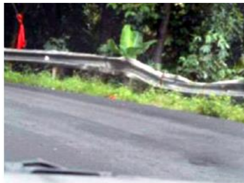
Pagar yang rusak tersebut tidak akan berfungsi dengan baik jika ditabrak lagi oleh kendaraan yang lepas kendali.
