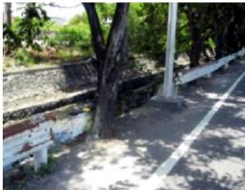
Bagian pembatas yang hilang menimbulkan bahaya yang tidak dapat diselamatkan.
