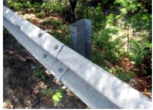
Balok yang berfungsi sebagai sandaran/penyokong pagar jika hilang maka akan memengaruhi kinerja kecelakaan.
