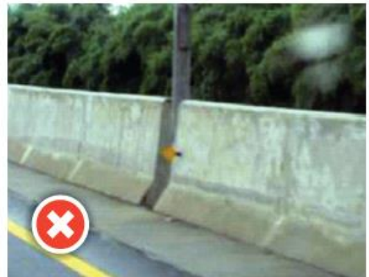
Tiang lampu dalam beton pembatas yang meninggalkan celah bisa menjadi bahaya jika ditabrak oleh kendaraan berkecepatan tinggi.
