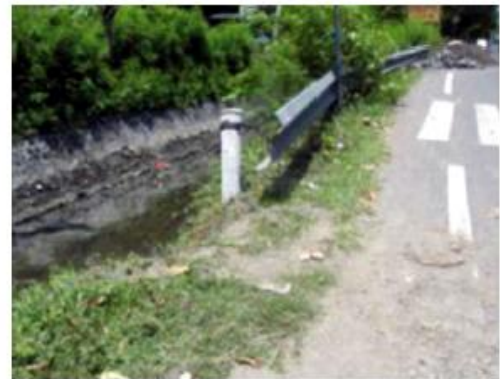
Pagar pembatas yang tidak pas dengan tiang-tiang dan bagian-bagian yang hilang dari pagar pembatas akan berakibat pembatas tidak bekerja seperti yang diharapkan apabila terjadi kecelakaan.
