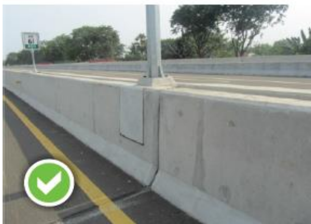
Tiang lampu ini dipasang pada bagian atas pembatas. Hal ini untuk menahan pembatas yang berkesinambungan
