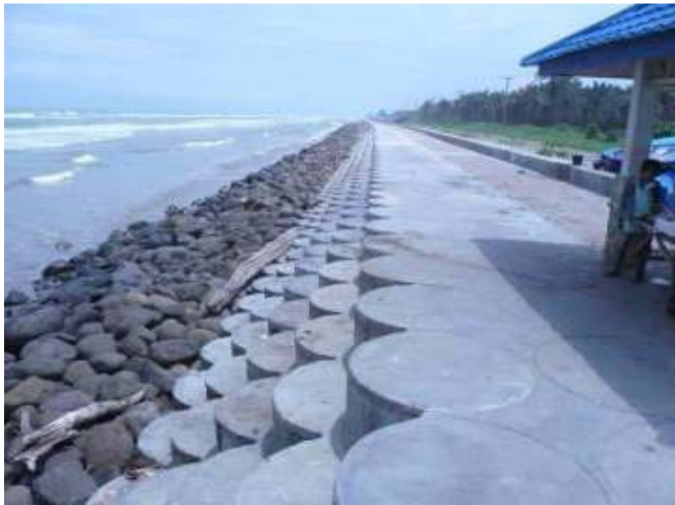
Photo 2 Bangunan Pengaman Pantai – Tembok laut
