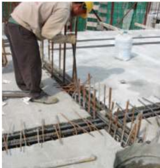
Gambar 4.39 Untuk komponen beton precast dengan sambungan cor ditempat, balut baja tulangan sesuai dengan yang diperlukan
