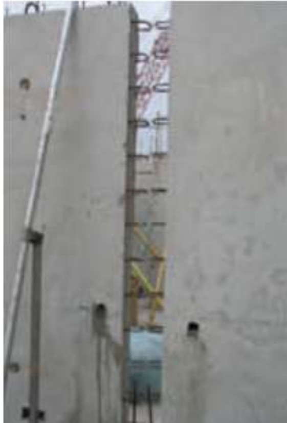
Gambar 4.27 Tulangan pada sambungan panel
