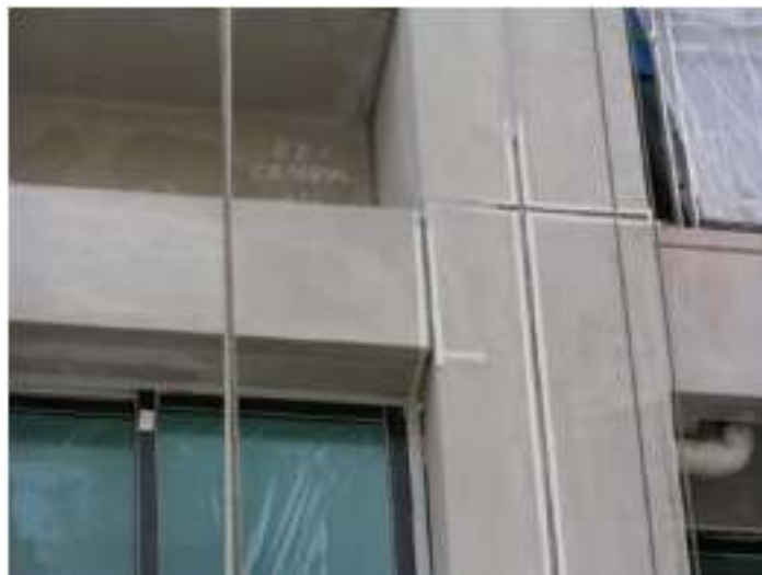
Gambar 4.29 Celah sambungan harus konsisten untuk memungkinkan pemasangan yang tepat dari sealant atau nat, supaya lebih kedap air
