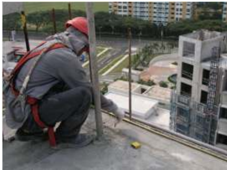
- Gambar 4.13 Untuk komponen precast vertikal , periksa posisi dan kesejajaran batang atau tulangan sebelum pengangkatan/pengerekan dilakukan .
