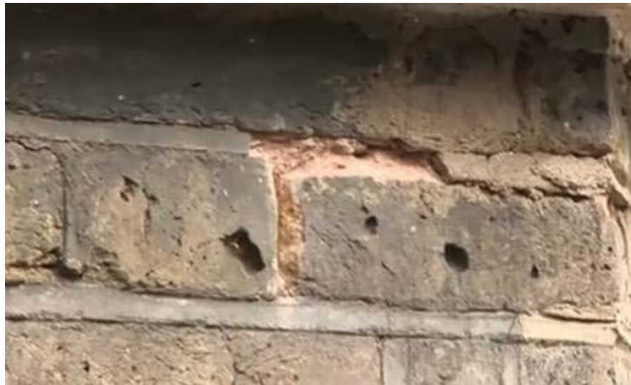
Gbr 4.99 Kerusakan pada salah satu bata
