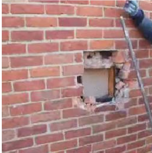
Gbr 4.98 Kerusakan pada sebagian dinding pasangan bata
