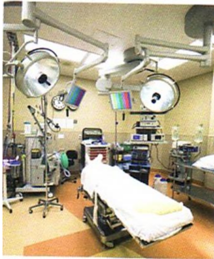
Lampu yang dipasang diruang operasi
